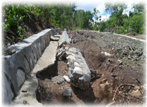
Drainase baru 6 bulan sudah rusak
