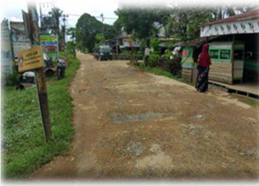
Jalan belum 1 tahun sudah rusak
